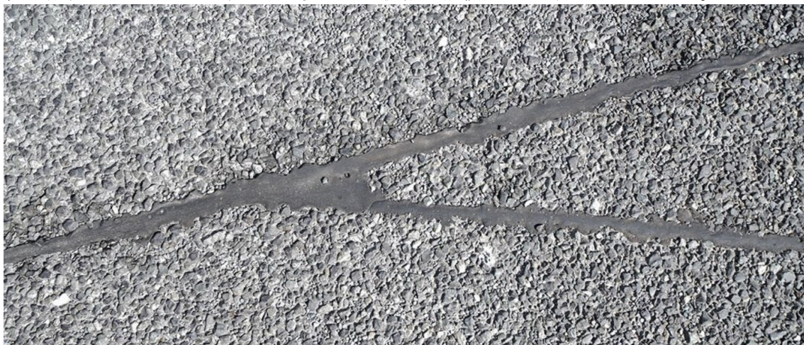
写真：アスファルトに埋め込まれている電磁誘導線
