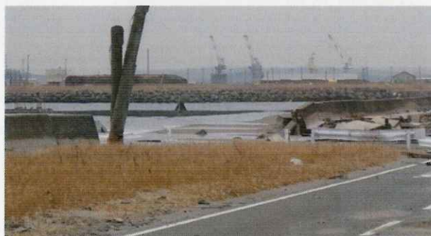
▲被災した雲雀野海岸堤防の状況(3月21日撮影)
