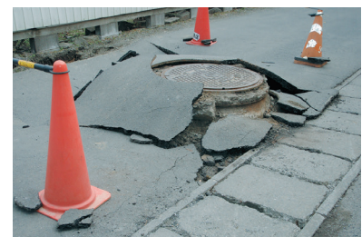
液状化で浮き上がったマンホール（桃生町）
