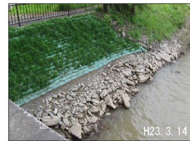
取り付け部法面の崩落
