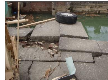
沈下・欠損の拡大
