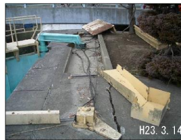
開閉機の破損（旧北上川側）
