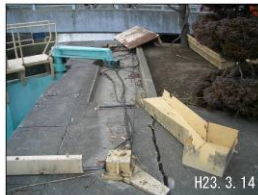
開閉機の破損 (旧北上川側)
