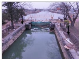
石積背面の沈下
