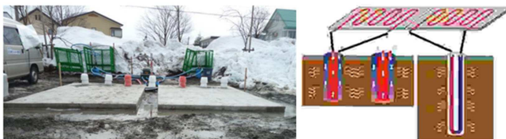
図7 50m 深熱交換井戸と 10m 深熱交換井戸実証実験(左)、同実証実験融雪システム(右) 青森県地中熱・温泉熱利用ポテンシャル調査事業報告書
