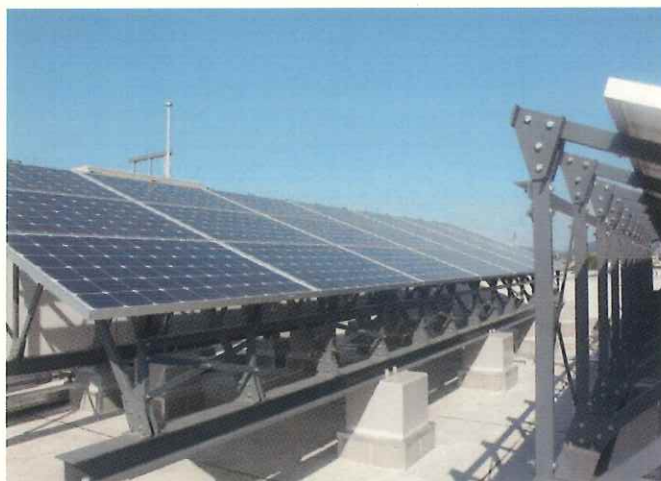
■太陽光発電システム（石巻消防署西分署）
