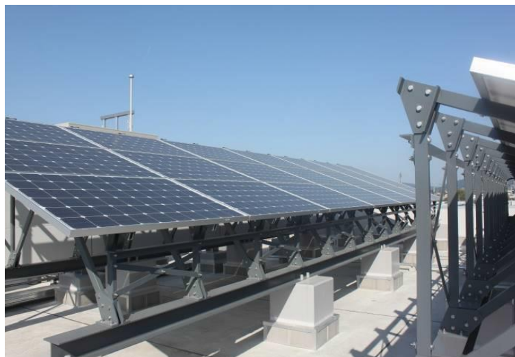
《図2-5 太陽光発電システム（石巻消防署西分署）》 写真：石巻市
