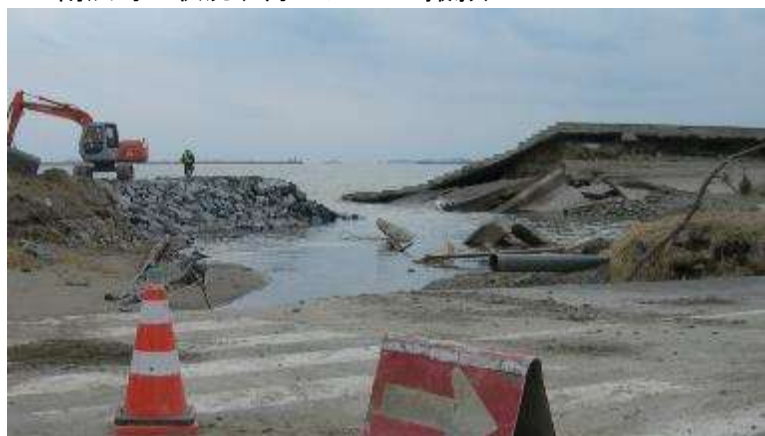
▲被災した長浜海岸堤防の状況(3月25日撮影)
