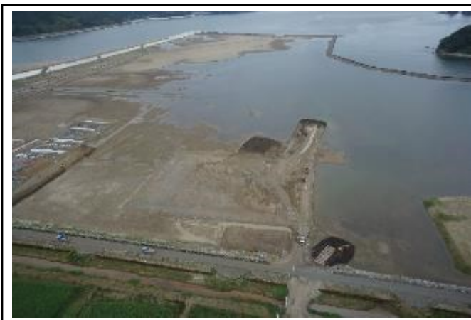
左：復旧前の湛水の状況（平成 28 年 6 月）
