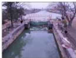
石積背面の沈下
