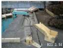
開閉機の破損（旧北上川側）
