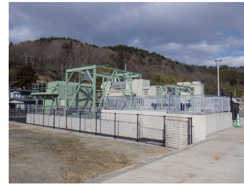
折立第一排水ポンプ場(運用開始)
