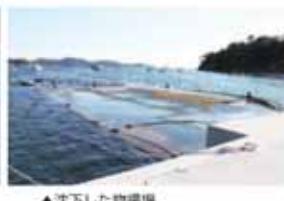
▲沈下した物揚場
