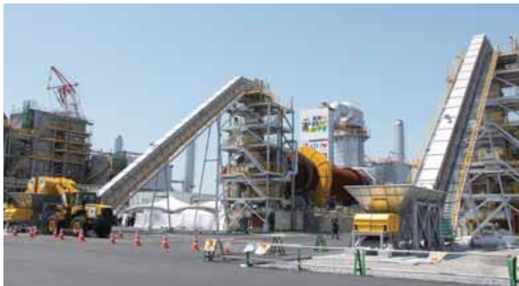
▲災害廃棄物処理施設(平成24年(2012)5月13日)
