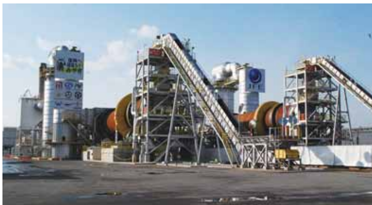
▲災害廃棄物処理施設(平成26年(2014)1月18日)
