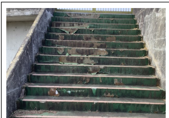
(安全点検で見つかったプール階段の剥離)
