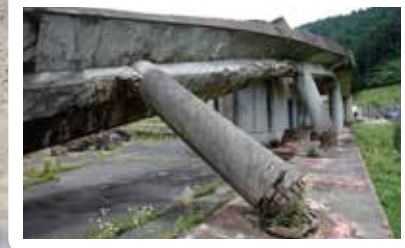
ねじり倒された渡り廊下
