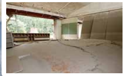
津波の威力で盛り上がった床
