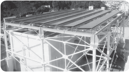
▲本庁舎屋上に設置された太陽光発電パネル
