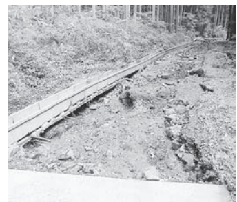
台風18号による被害
