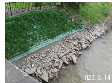
取り付け部法面の崩落
