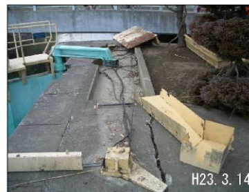
開閉機の破損（旧北上川側）
