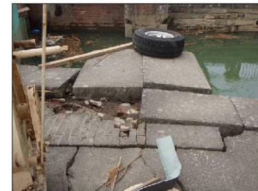
沈下・欠損の拡大
