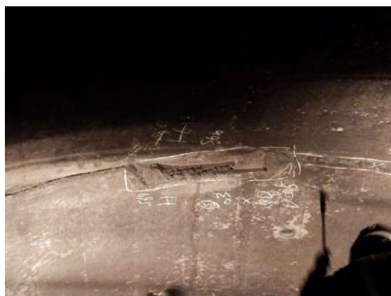
浮き・はく離変状状況（牧山東トンネル）
