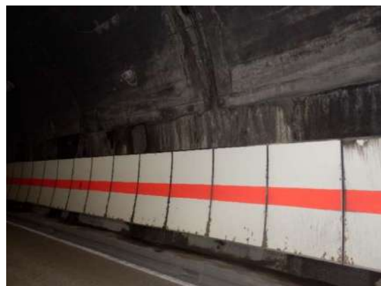
漏水変状状況（牧山西トンネル）
