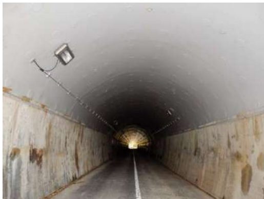
トンネルアーチ部に設置された照明施設 ( 雄勝トンネル )
