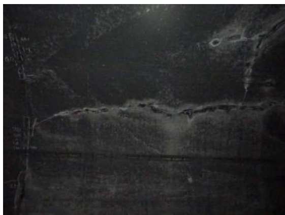
ひび割れ変状状況（牧山東トンネル）
