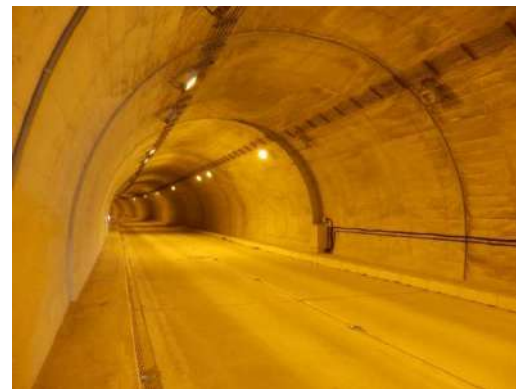
トンネルアーチ部に設置された照明施設 ( サン・ファントンネル )
