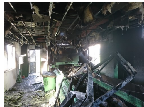
リチウムイオン電池の発火が原因で、リサイクル工場の建屋・設備が焼けてしまった事例 <公益財団法人日本容器包装リサイクル協会HP>
