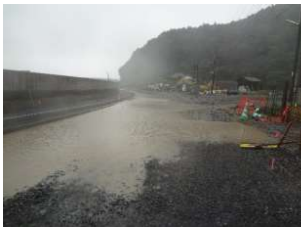
<工事着手前（排水不良の状況）>
