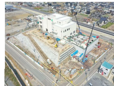
石巻港排水ポンプ場 令和4年5月現在
