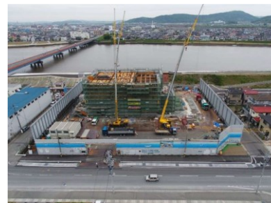
不動沢排水ポンプ場 (令和4年5月現在)
