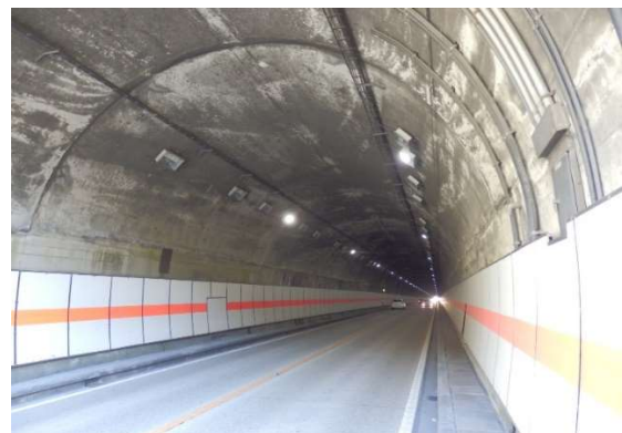
トンネルアーチ部に設置された照明施設 (牧山東トンネル)
