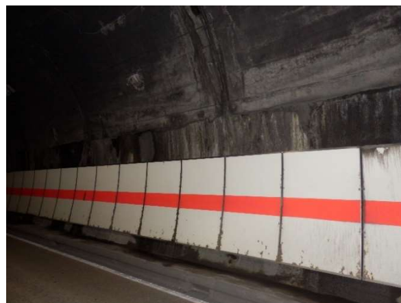
漏水変状状況 (牧山西トンネル)
