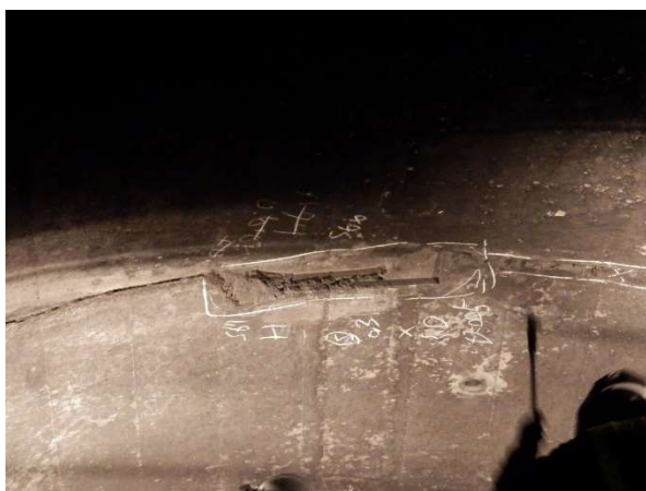
浮き・はく離変状状況 (牧山東トンネル)
