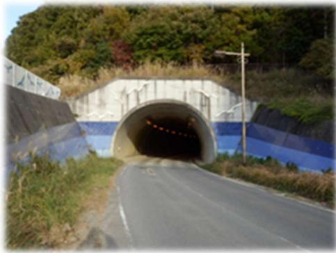
市道梨木畑・祝田藤ヶ崎線 サン・ファントンネル(1996年竣工)
