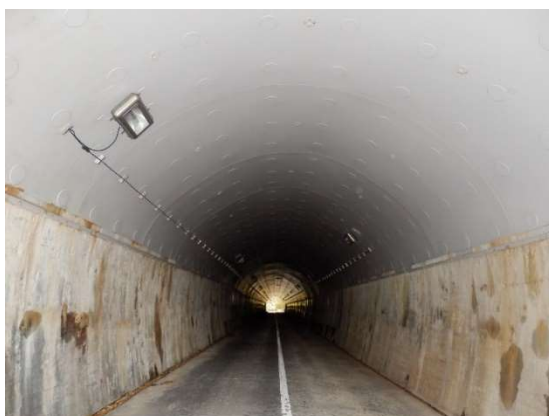
トンネルアーチ部に設置された照明施設 (雄勝トンネル)
