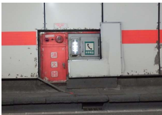
トンネル内に設置された非常用施設 (牧山西トンネル)
