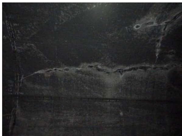
ひび割れ変状状況 (牧山東トンネル)
