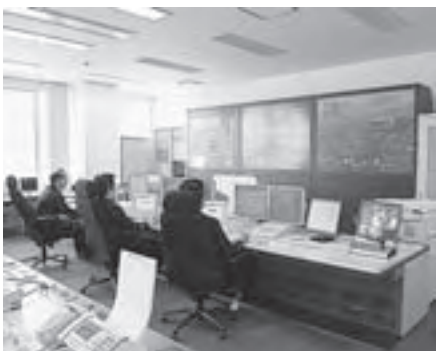
▲最新鋭の高機能消防指令センター
