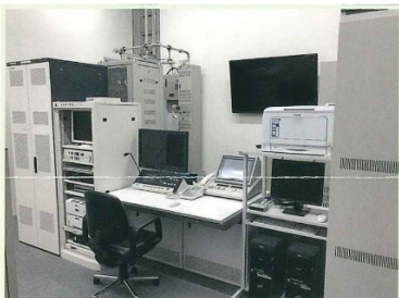
無線室 (通信指令室)
