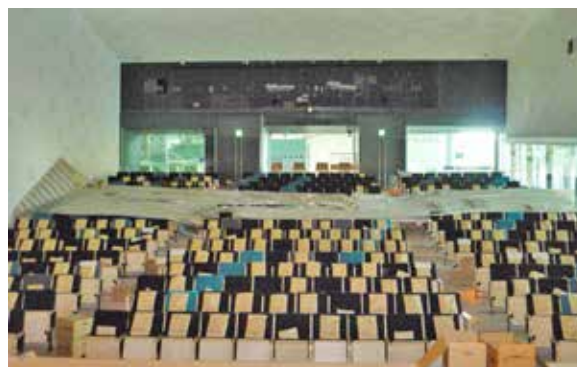
地震で天井が落下した遊楽館のホール
