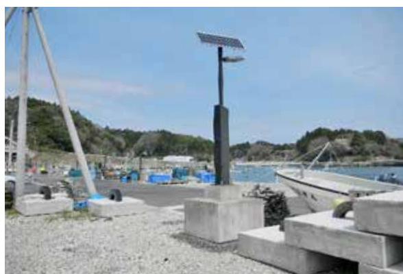
漁港に設置されたソーラー照明灯
