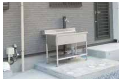
外流し(雄勝中央復興住宅)
