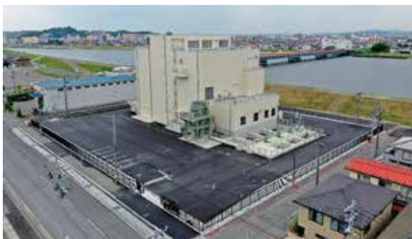
不動沢排水ポンプ場(石巻地区・不動町)
