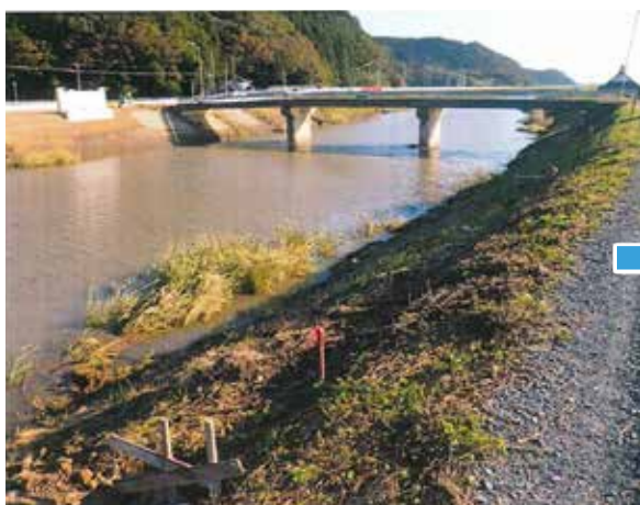
本地橋復旧前(北上地区・橋浦)
