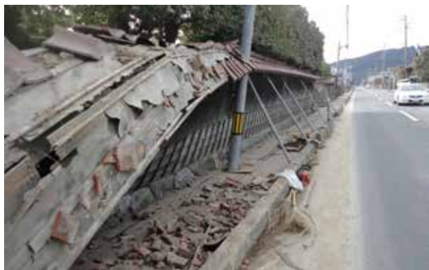
地震により倒壊した塀。(神取)
