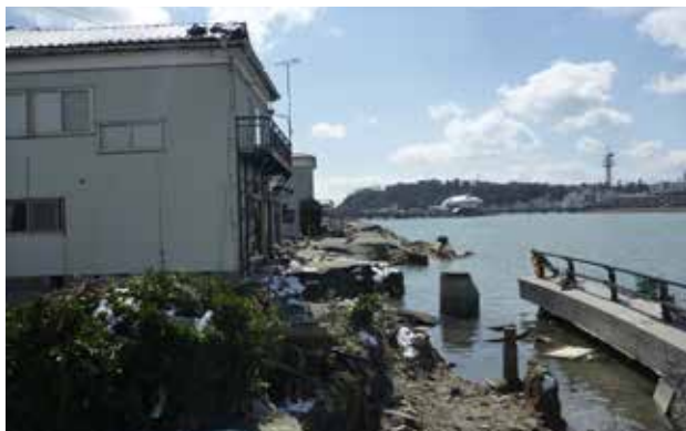
護岸が破壊され、川と住宅の境がなくなっている。(八幡町)
