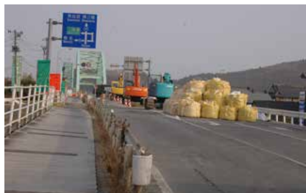
国道45号では天王橋付近で道路が陥没。橋は通行が可能だった。（鹿又）
