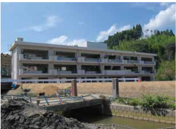
津波で水没した吉浜小学校。内部も破壊されている。校舎の時計は地震が発生した午後2時46分で止まっている。(北上地区・十三浜)
