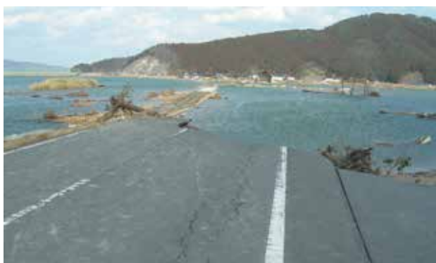
津波により堤防ごと流失した県道30号。大川中学校付近から北上川下流側を写している。この先に大川小学校がある。(針岡)
