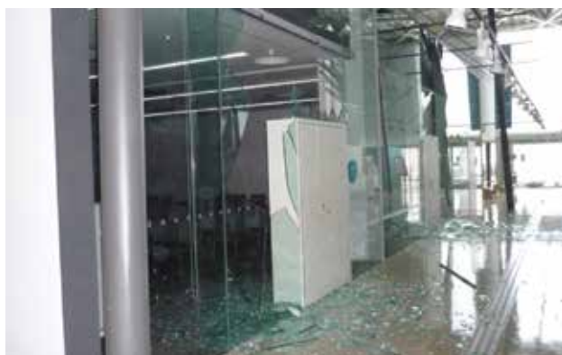
遊楽館では、地震によりガラスが破損するなどの被害を受けた。（北村）
