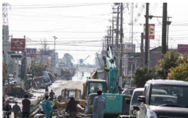
中浦橋から海岸方向を撮影。低平地には海水が残っている。（中浦、三ツ股）
