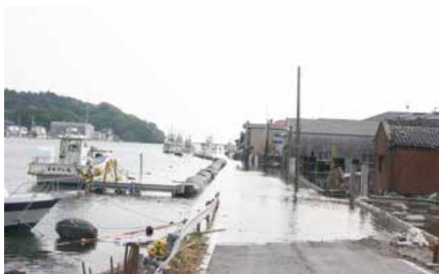
地盤沈下で海面より低くなり冠水する状況となった岸壁。（石巻地区・渡波漁港）
