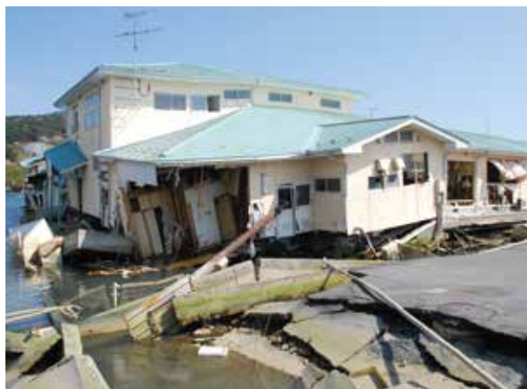
はまなす保育所は、建物はその場に残ったが、土台が根こそぎ崩れ全壊となった。(石巻地区・長浜町)
