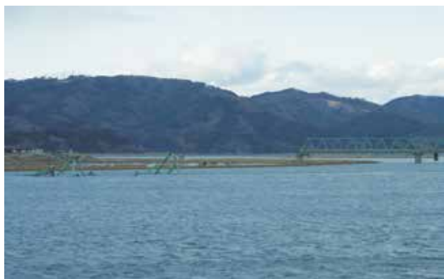
橋浦と河北地区の釜谷を結ぶ新北上大橋は、津波により橋浦側の左岸部分が落橋した。(橋浦)
