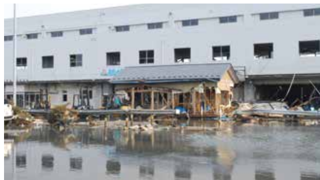
津波でガラスなどが割られた石巻売場管理棟。(石巻地区・魚町)
