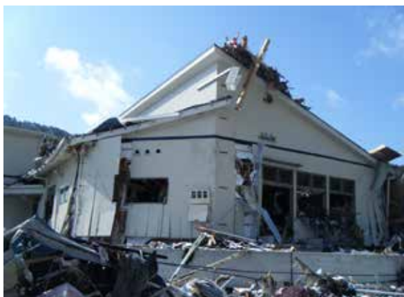
新築し移転を1カ月後に控えた雄勝保育所が津波により全壊した。(雄勝地区・味噌作)
