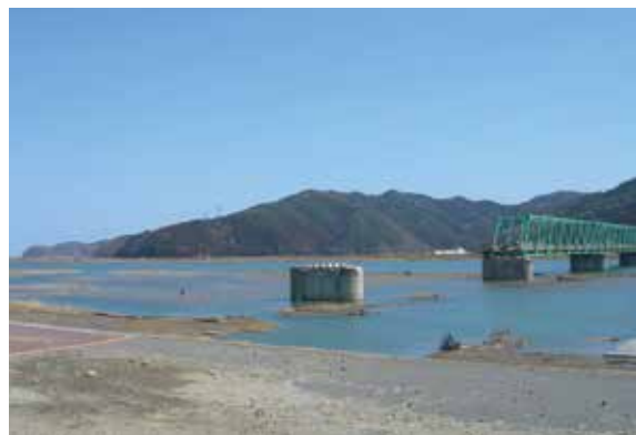
津波により、新北上大橋は左岸側の155mが流失した。(北上地区・橋浦)
