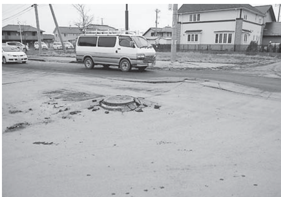
▲地震により甚大な被害を受けた下水道
