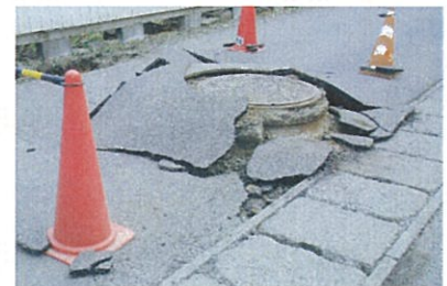
液状化で浮き上がったマンホール（桃生町）
